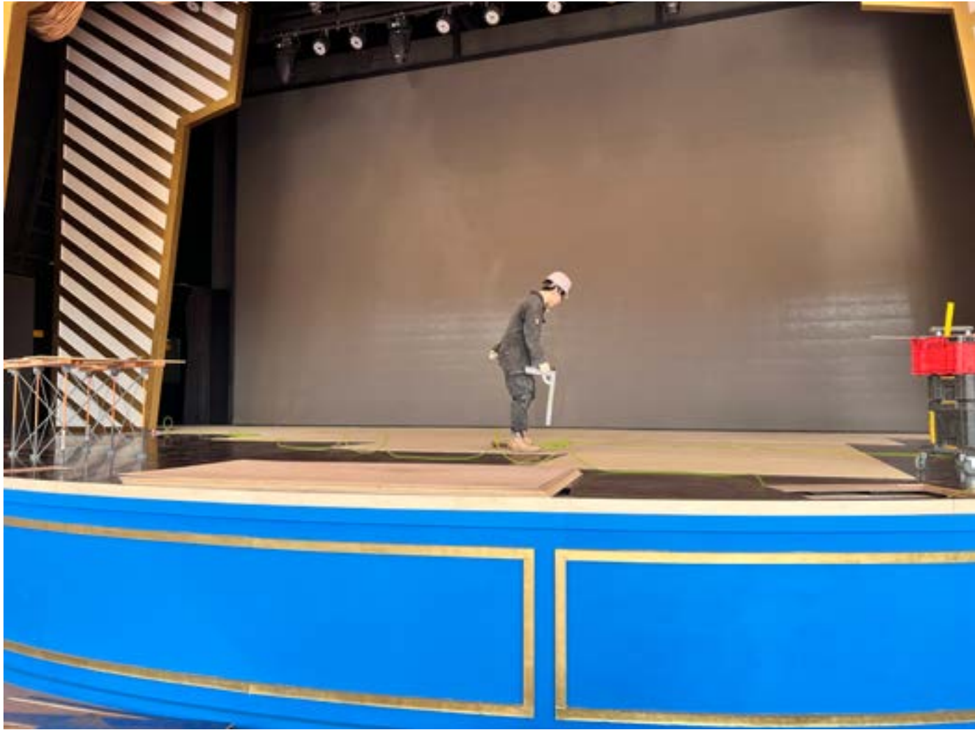
마지막 합판층을 설치하는 동안 점차 어두워져 무대 조명을 켜고 야간 작업을 이어갔습니다. 조명이 작업에 큰 도움이 됩니다. 빛이 작업을 격려하는 거 같습니다.
